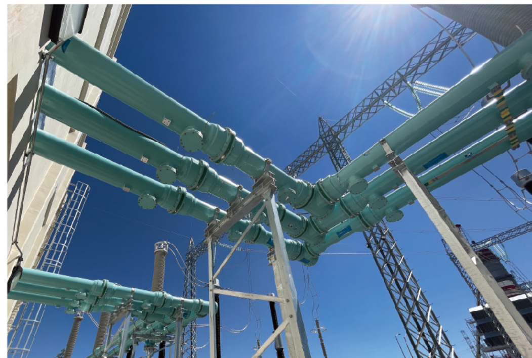
墨西哥CFE EL SAUZ 420 kV GIS项目
