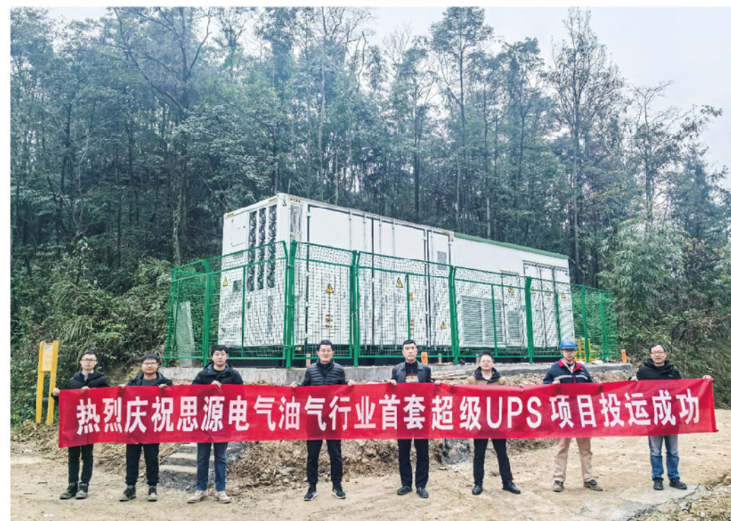
四川长宁气田抗晃电项目
