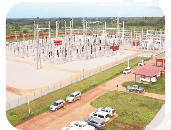
Gagnoa 225kV Substation EPC Project, Côte d'Ivoire
