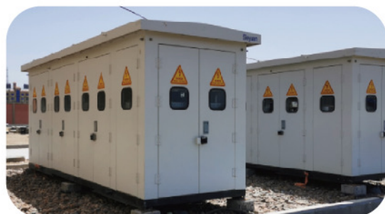
埃及 Assuit East 22kV/11kV 箱式电容器装置
