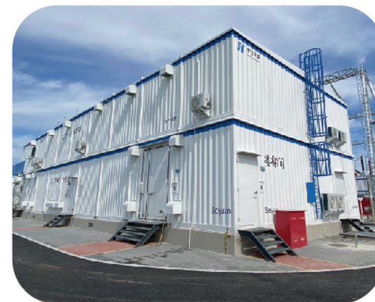
华能吉林昊安20万千瓦风电项目
