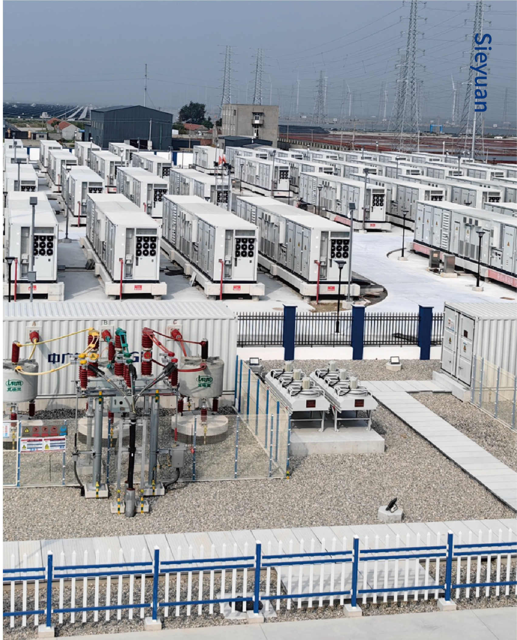
山东莱州土山600MW光伏项目 (244.2MW/488.4MWh锂电+4MW/30s超容)混合储能系统项目
