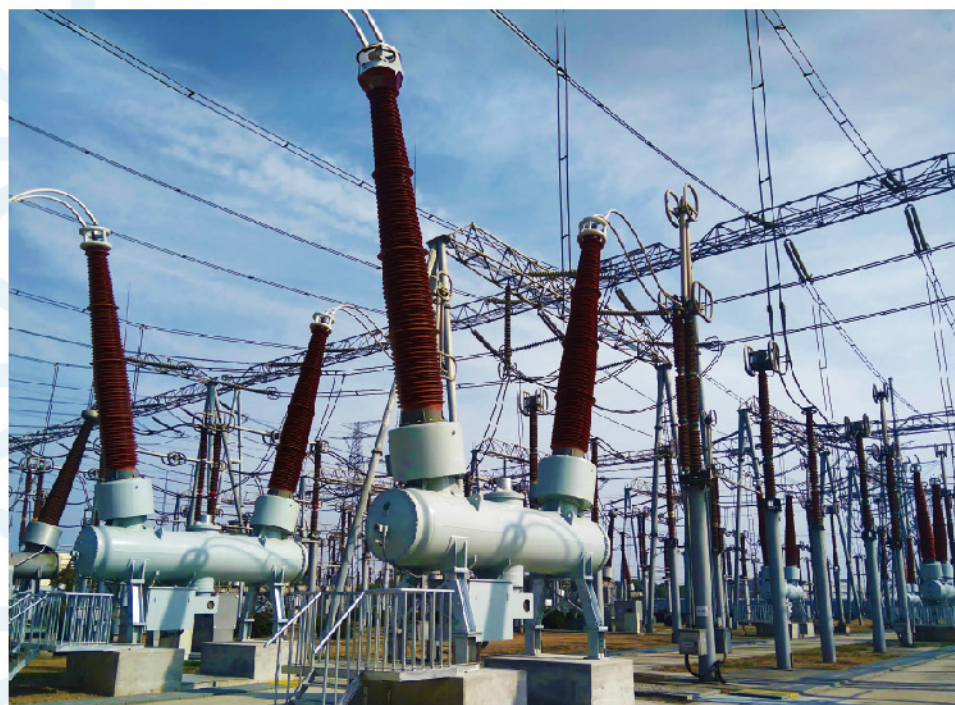
国网上海南桥 500kV 变电站
