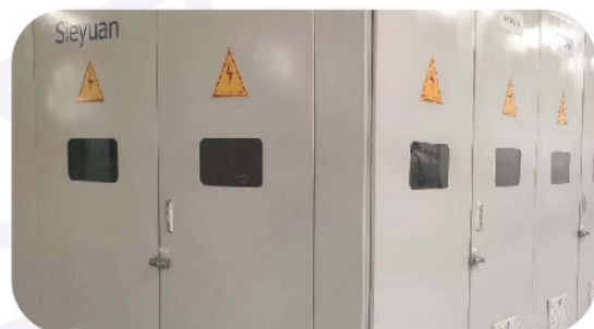
沙特 Jubail 3A SWRO plant-33kV 柜式电容器装置
