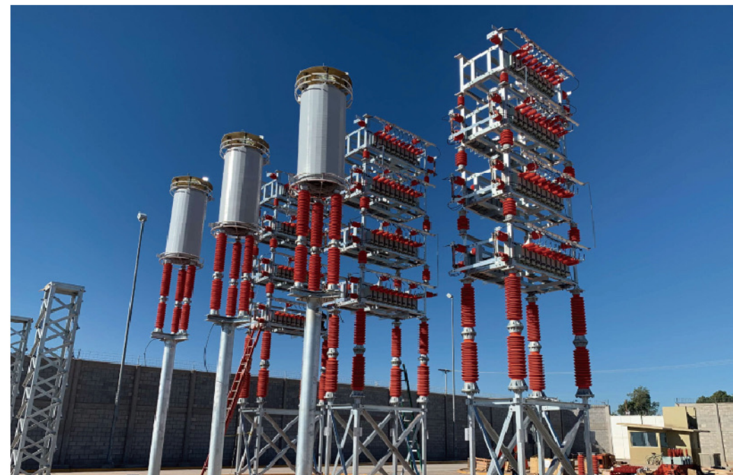
墨西哥国家电网公司 110kV SE MEXICAL EAST 电站项目
