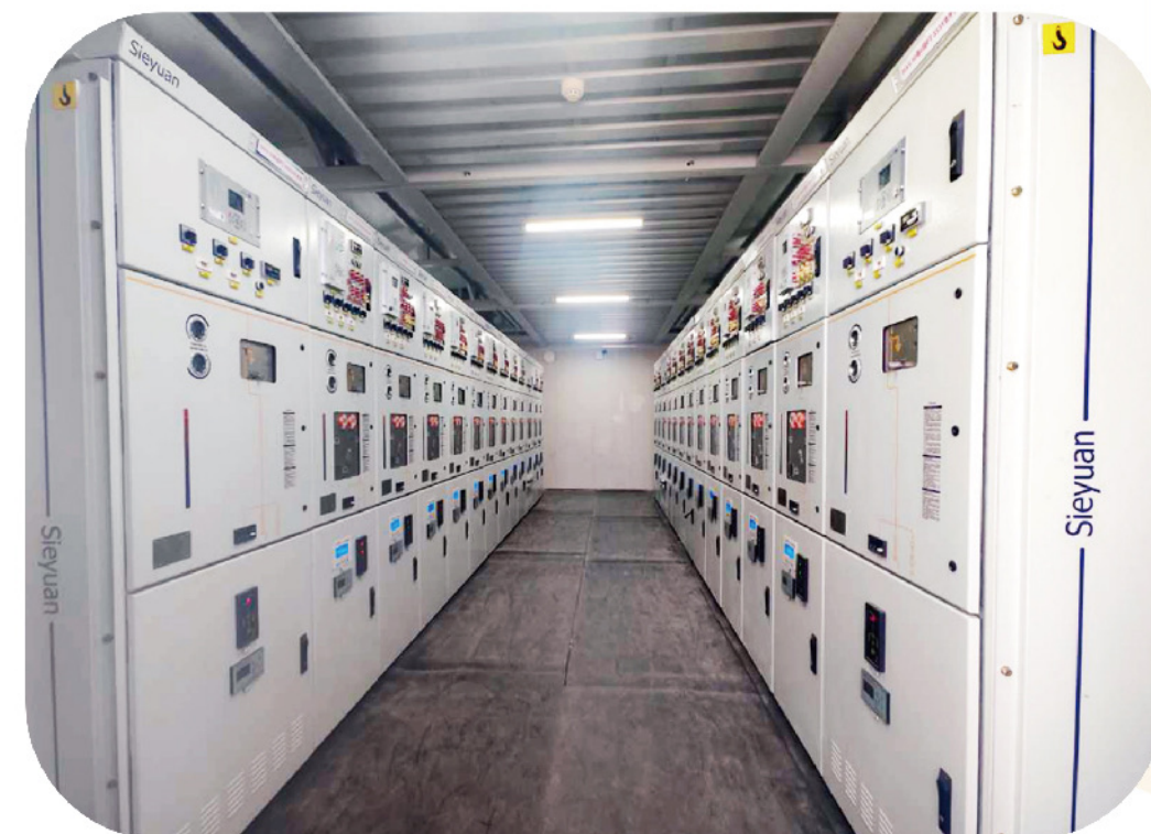
龙源电力新疆乌恰 220kV 升压站 35kV C-GIS
