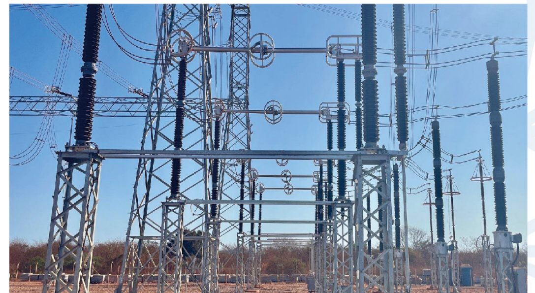
Wambo Wind Farm Stage 2, Australian 澳大利亚隔离开关项目
