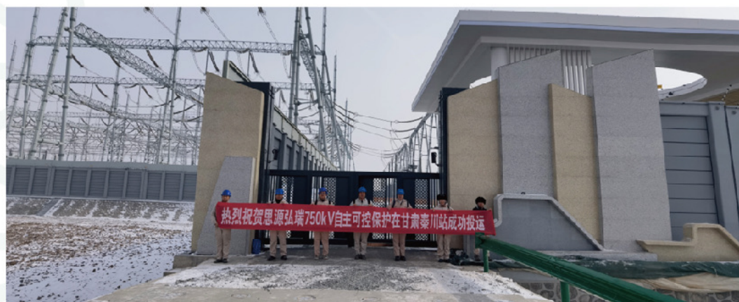
继电保护产品在 750kV 秦川变电站稳定运行
